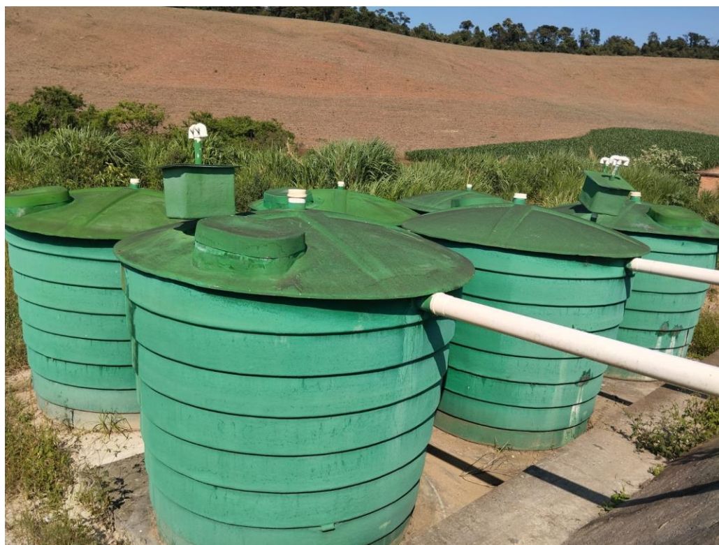
FOTO 2 – Tratamento Secundário composto por Reatores UASB seguidos de Filtro Anaeróbio.
